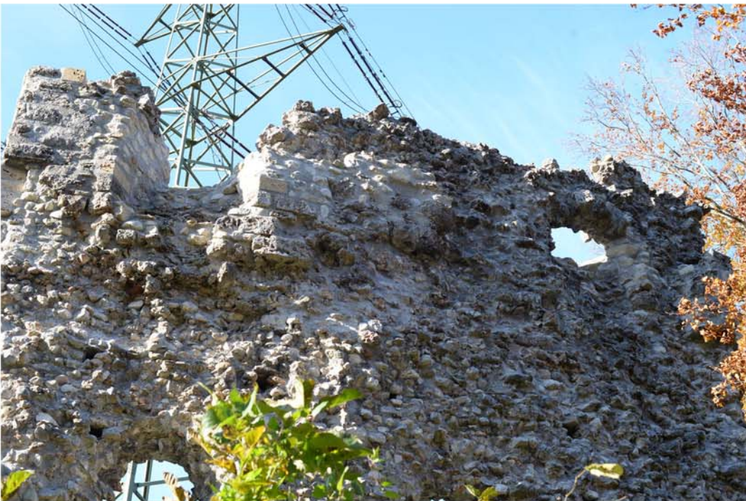
Abb. 30 Schänis SG, Ruine Niederwindegg, 2020. Mauer M2, oberer Teil der Aussenfassade mit den Öffnungen 4 und 5 nach Abschluss der Sanierungsarbeiten, von Nordosten. Die Aufnahme macht deutlich, dass ein am Standort des Fotografen stehender Angreifer problemlos aus der Öffnung 4 beschossen werden konnte.
