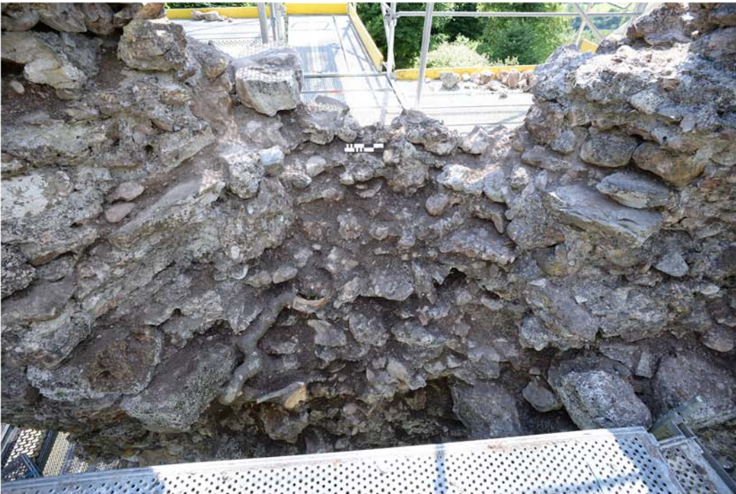
Abb. 28 Schanis SG, Ruine Niederwindegg, 2020. Mauer M2, Öffnung 4, von Nordosten. Blick in die von Schutt und Bewuchs befreite Öffnung mit den nach aussen laufenden Leibungen und der steil abfallenden Bank.
