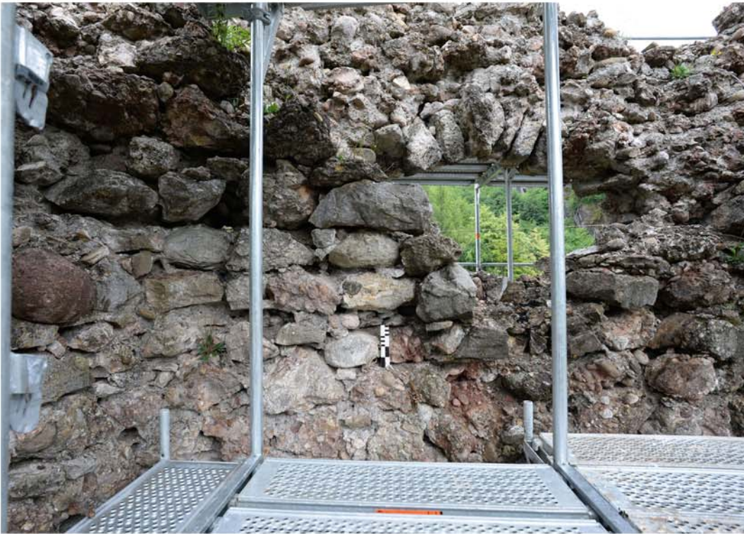
Abb. 31 Schänis SG, Ruine Niederwindegg, 2020. Mauer M2. Der Mauerinnenmantel im Bereich der Öffnung 5 besteht mehrheitlich aus roter Nagelfluh, von Südwesten. Der rote Stein am linken Bildrand ist ein Geröll aus Verrucano-Gestein.
