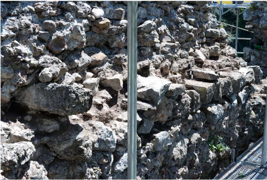
Abb. 11 Schänis SG, Ruine Niederwindegg, 2020. Mauer M2. Abbruchkron des inneren Mauermantels nach dem Entfernen des Bewuchses und loser Steine, von Westen.
